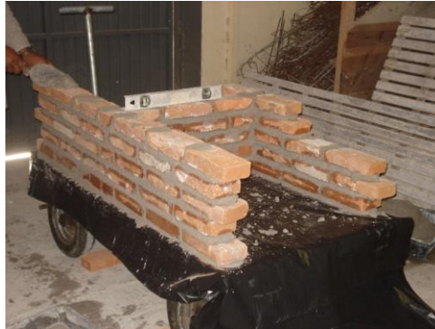
Figura 1 - Imagem da construção da alvenaria com tijolo maciço, areia e cal hidráulica para a realização dos testes. Fonte: autora, 2011
